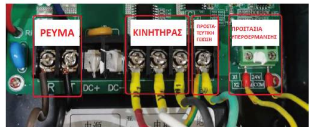
Μονοφασική καλωδίωση (επίκαιρη εικόνα)
